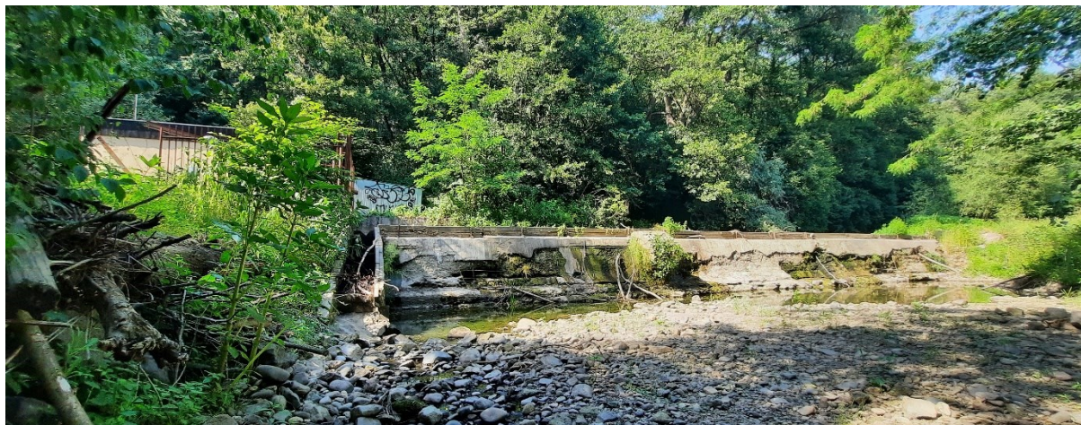
Obrázok č. 5. Objekt MVE v havarijnom stave, tvorí migračnú bariéru a odvádza väčšinu vody mimo vodný tok. MVE nepracuje. Technický stav vodnej stavby je rizikom v prípade zvýšeného prietoku, jej kolaps môže spôsobiť ohrozenie obyvateľov, ich majetku, zdravia a dokonca aj životov.
